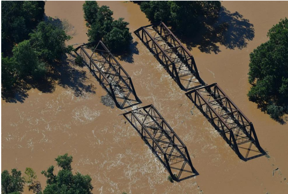
Fig. 15: Puente inundado por las crecidas de agua en el condado de Somerset.
